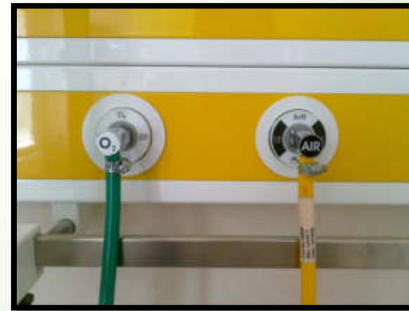
Con. la sistema centralizată de aer și O 2
