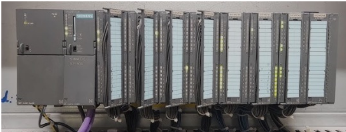
PLC din Seria Siemens S7-300 cu CPU și module I/O
